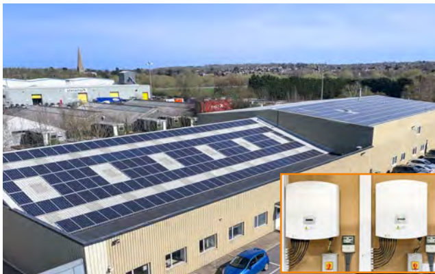
Grundfos Rooftop, UK 123.4kW
