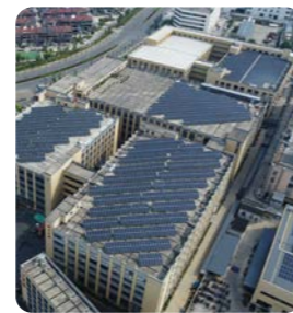
安升吉达光伏电站
